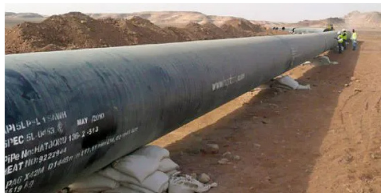
Pipeline de l'aquifère de Disi (Halcrow.com)
